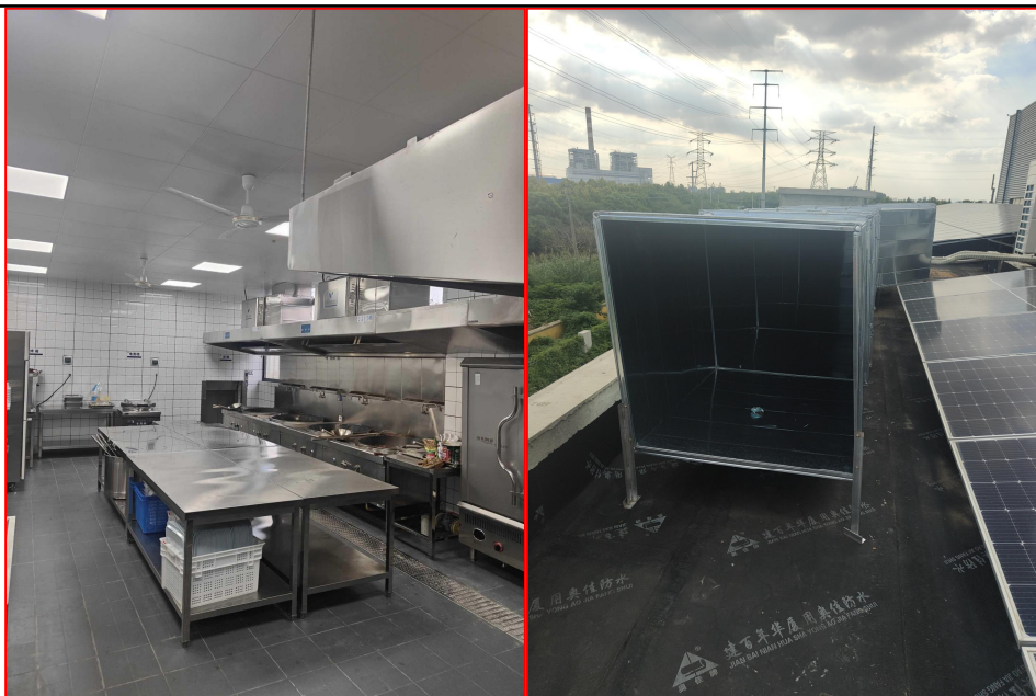
图 3-3 食堂油烟管道
